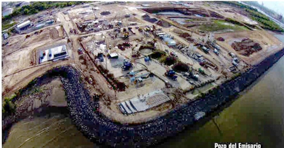
Pozo del Emisario Planta Riachuelo.
